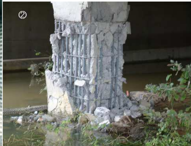
・付着割裂破壊
